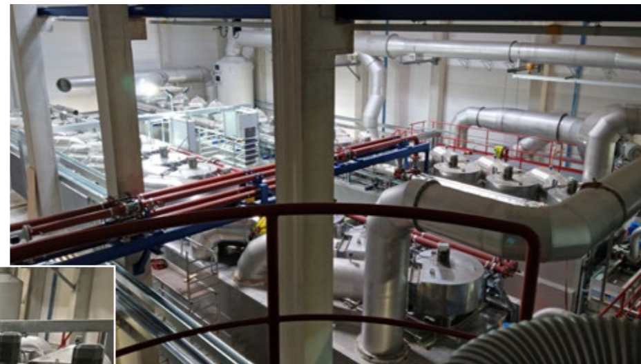
Übersicht eines Teils des Klärschlamm-trockners vom Zwischenspeicher aus fotografiert.
