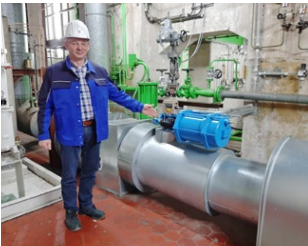
Axel Kahl im Heizkraftwerk Mittelfeld vor einem eingebauten Regelventil
