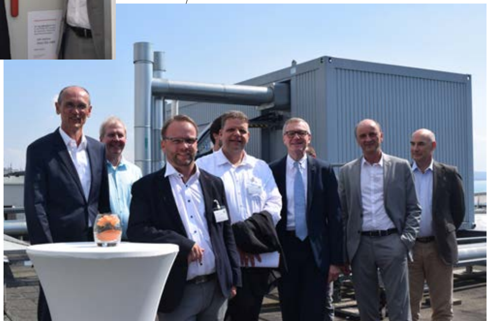
Kälteerzeugungsanlage auf dem Dach der Kurfürsten Galerie
