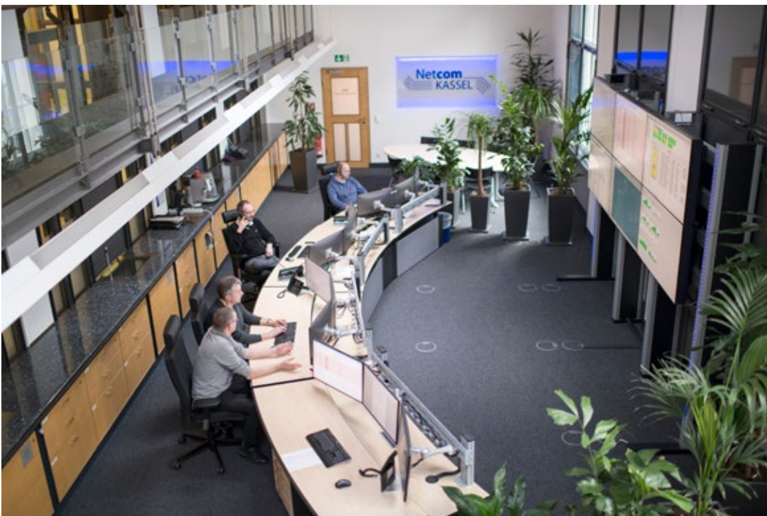
Alles im Blick: Die Mitarbeiter der Netcom Kassel überwachen im NOC (Network Operation Center) das gesamte Telekommunikationsnetz der Breitband Nordhessen GmbH
