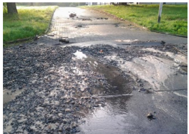
/ Typisches Zerstörungsbild durch einen Wasserrohrbruch
