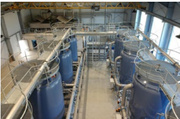
Die Filteranlage besteht aus insgesamt 8 Filtern, jeweils mit einem Durchmesser von drei Metern und einer Höhe von sechs Metern.
